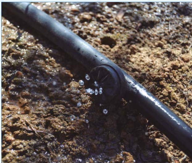
Fotografía 3. Detalle de gotero pinchado sobre línea portagotero.
